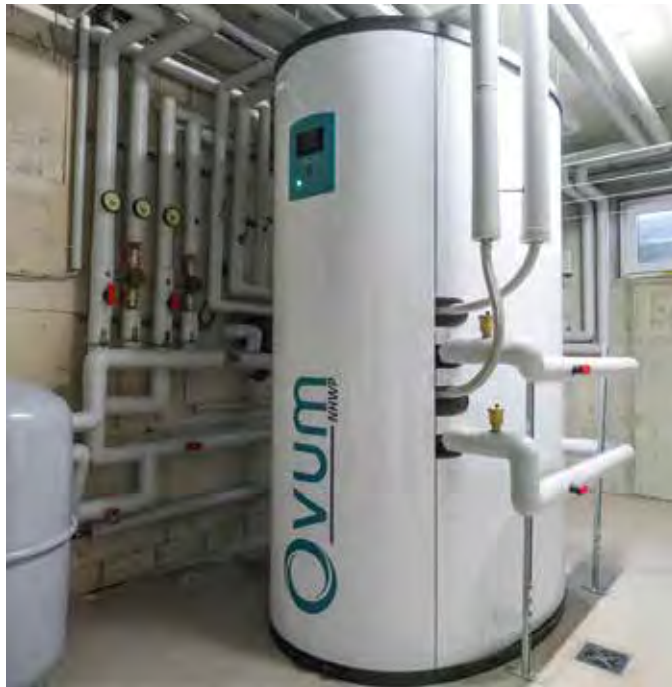
Inbetriebnahme der weltweit effizientesten Wärmepumpe bei einem Kunden in Hohenstaufen – für ein Haus mit ca. 250m 2 Fläche!
